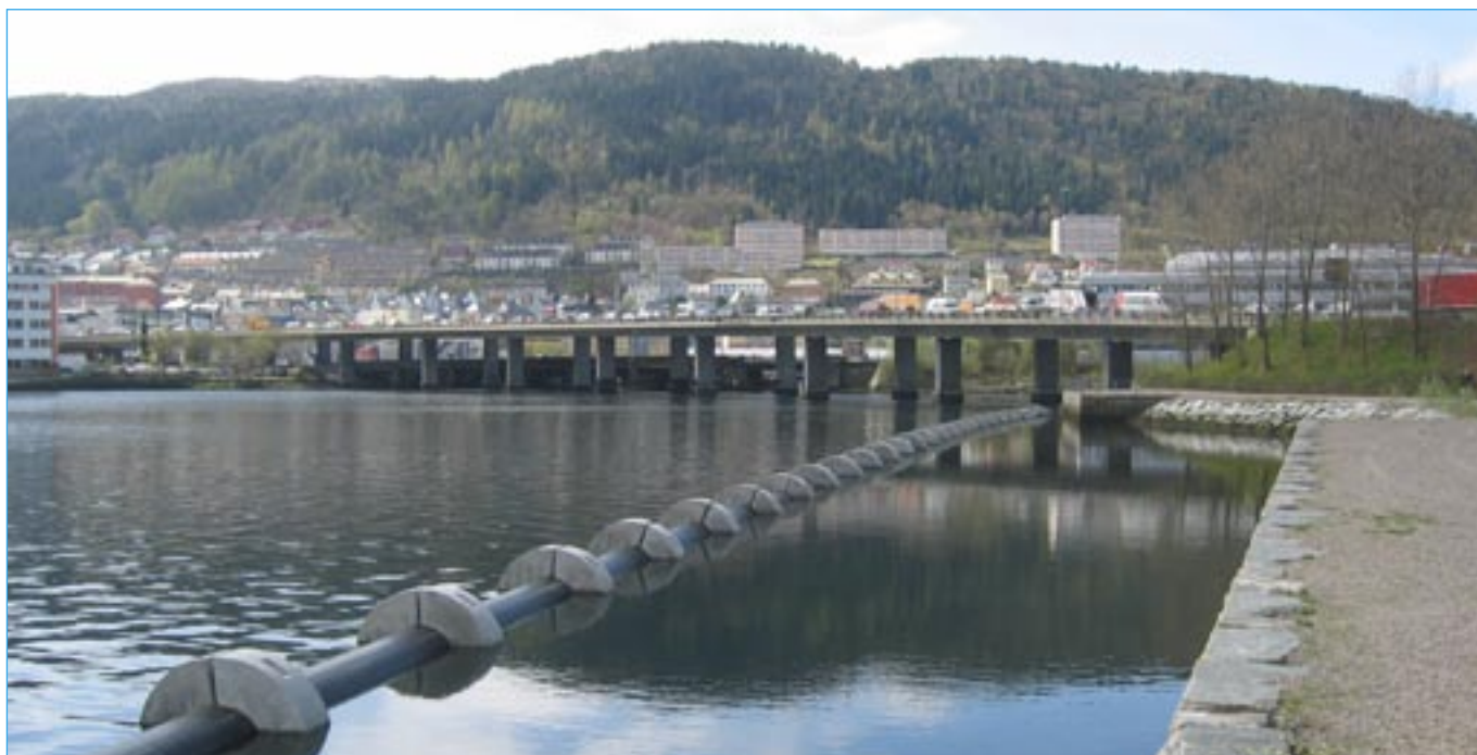
Vannledning med lodd påsatt
